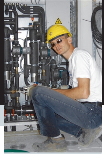
Ralph Berger, Leiter Forschung und Entwicklung bei Menerga, Mülheim, nimmt den Glykolverteilungsschrank in Betrieb.
