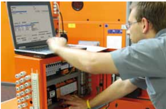
Anlagendiagnose mit modernster Technik
