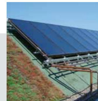
Regeneration mittels Solarthermie
